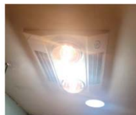
（図 9）浴室内暖房ライト
